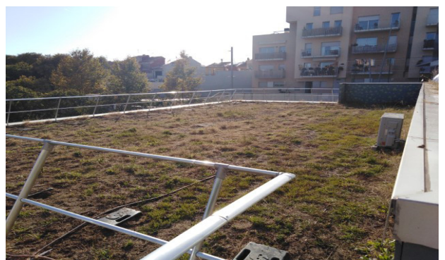
Seguretat coberta escola bressol Vallparadís
